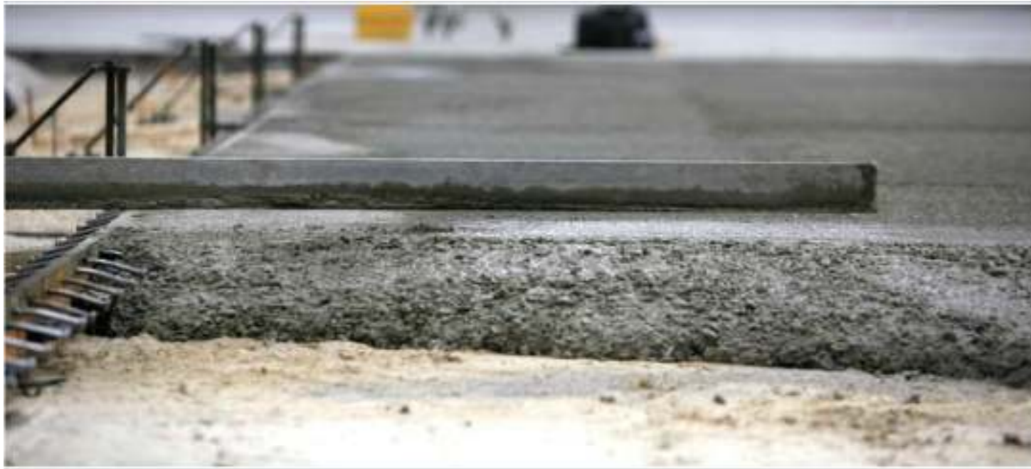
Thi công nhanh chóng với sàn bê tông trộn sợi thép (không có thanh thép)
